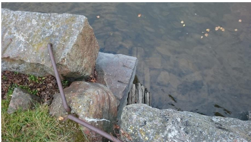
Kuva 3. Lähikuvassa harkkokivien alta pilkottavia rikkoutuneita hirsjiä. Kiviä on kiinnitetty toisiinsa rautatangoin. Kuvaussuunta koilliseen.
